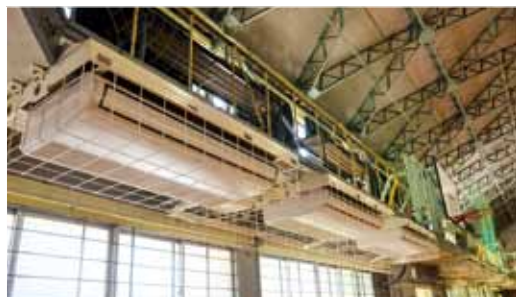
▲ 学校体育館の空調設備
