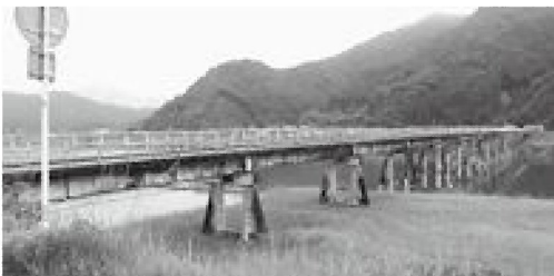
▲市の管理となっているが耐震化対策が未実施の長瀬橋
