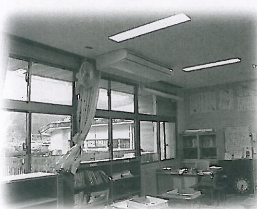
▲ 八幡小学校に設置されたエアコン
