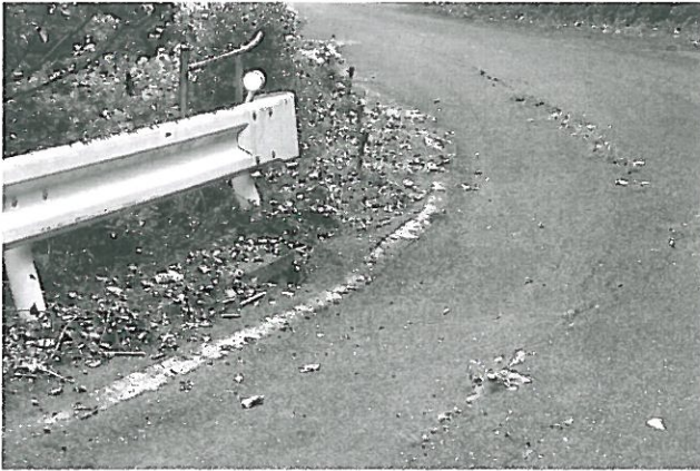
▲ 傷みの激しい路面
