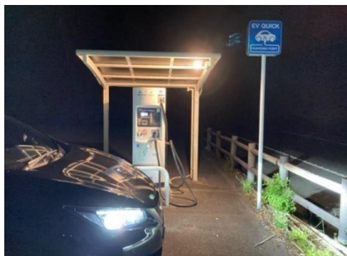
図 道の駅「うめ」の EV 充電器
