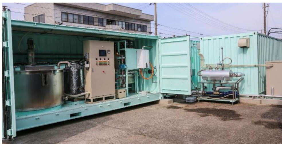
図 超小型バイオガスプラント
