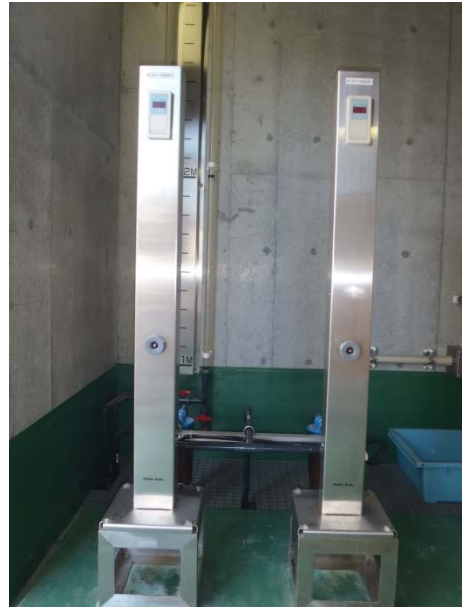
[残留塩素測定器（上岡第1浄水場）]
