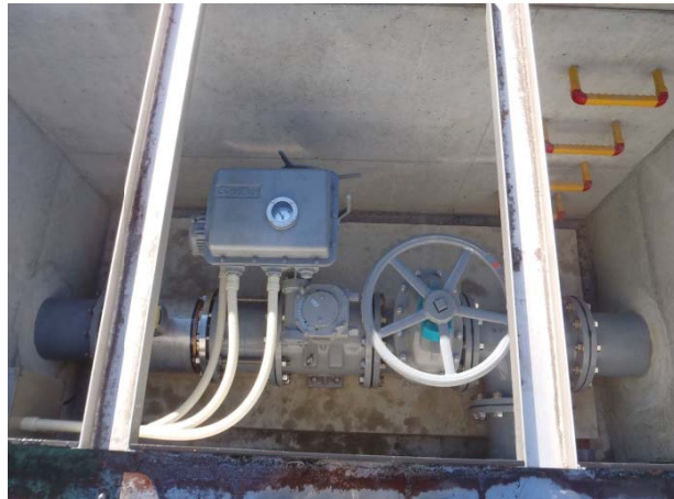
〔緊急遮断弁（堅田第2配水池）〕
