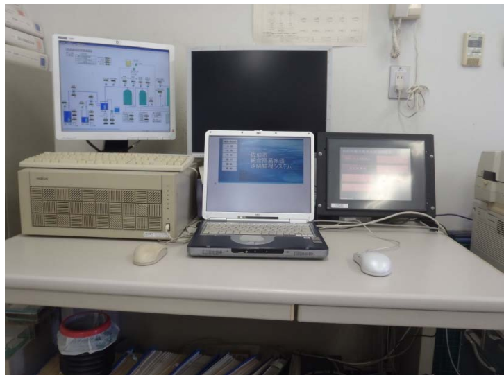
〔監視システム（上岡第1浄水場）〕
