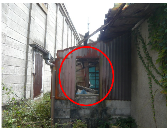
門扉がなく侵入できる
