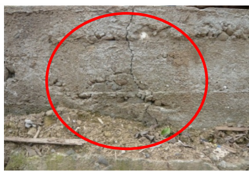
基礎にひび割れが発生している
