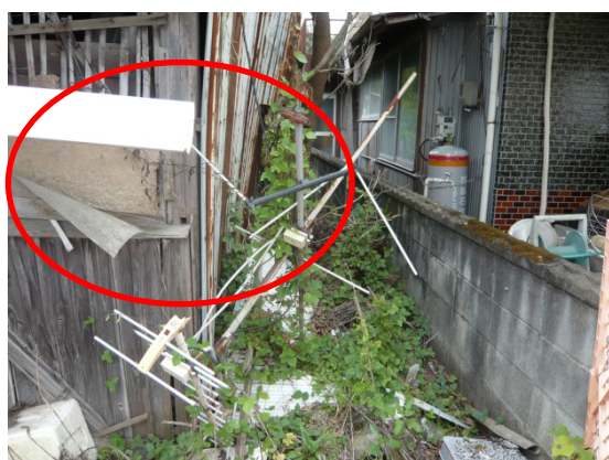
外壁材が剥がれている
