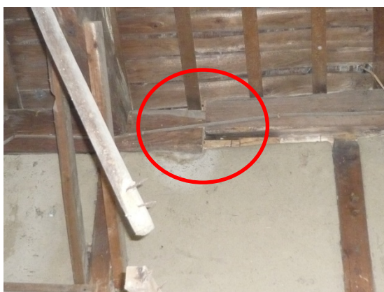
梁の接合部がずれている
