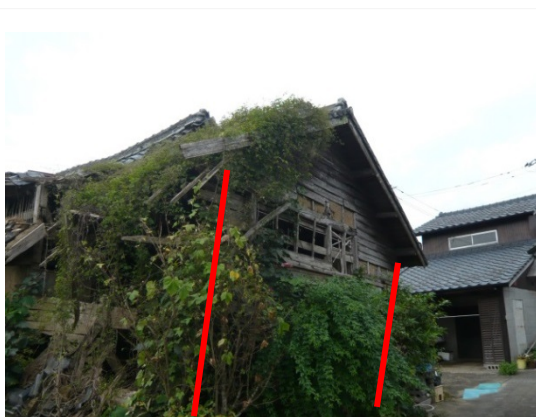
建物が傾斜し、道路に倒壊の危険
