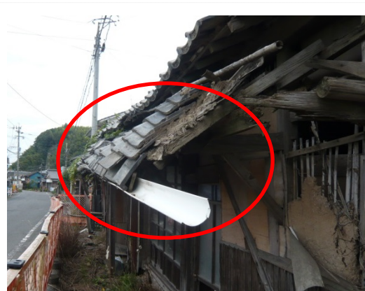
屋根、軒が垂れ下がっている
