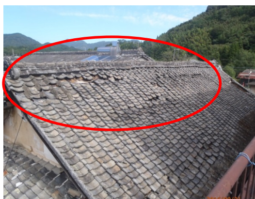
瓦が周囲に飛散する危険がある
