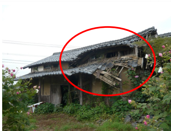
屋根が一部落下している
