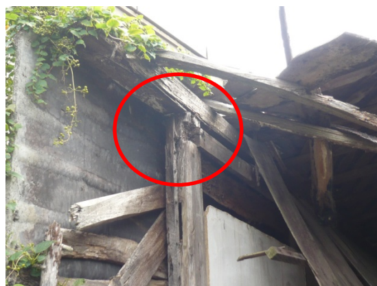
梁の腐食により欠損している
