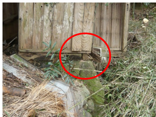
土台が腐朽して欠損している
