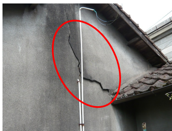
外装材にひび割れがある
