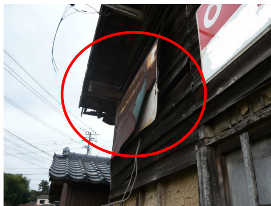
鉄製看板の落下の危険性
