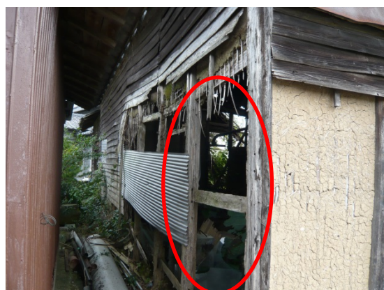
外壁材が無くなっている
