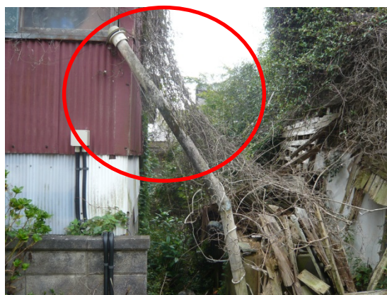
臭気筒が隣地へ倒れている
