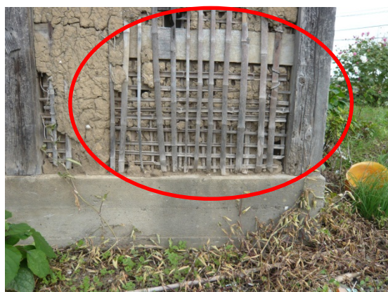
外壁材が剥がれて土壁が露出
