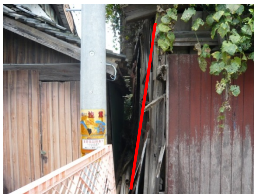
柱が傾斜している
