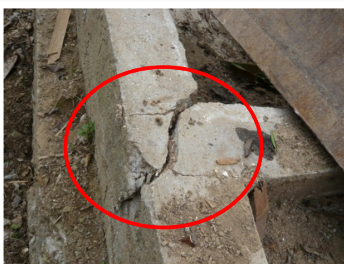
基礎がひび割れ、土台が無い
