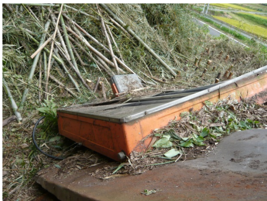
屋上給湯設備の落下
