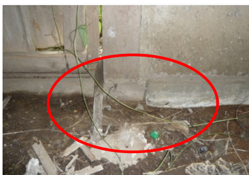
基礎、土台がずれている
