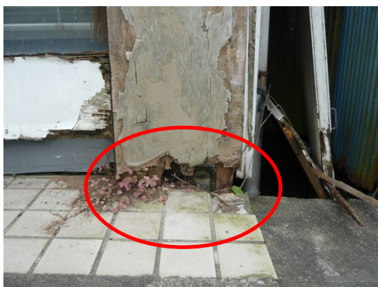
柱脚が腐朽し欠損している
