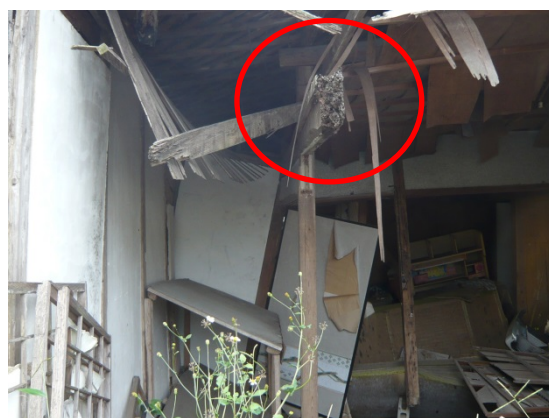
柱、梁が破損している
