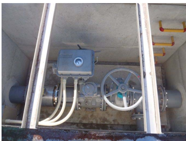
[緊急遮断弁 (堅田第2配水池)]
