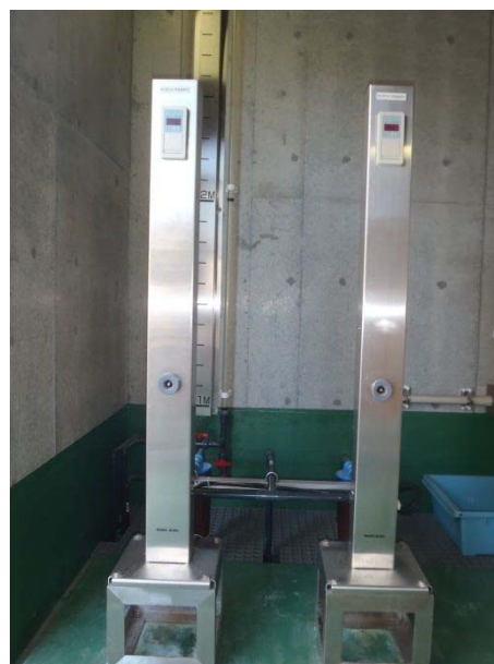
[残留塩素測定器（上岡第1浄水場）]
