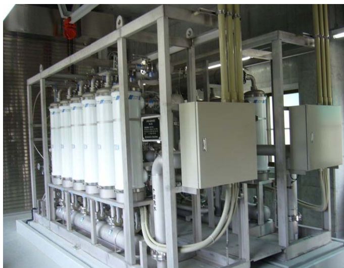
【膜ろ過設備（米水津浦代小浦竹野浦簡易水道）】
