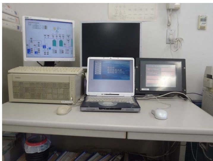
[監視システム（上岡第1浄水場）]
