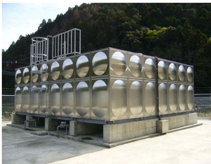
【ステンレス製配水池（蒲江波当津簡易水道）】
