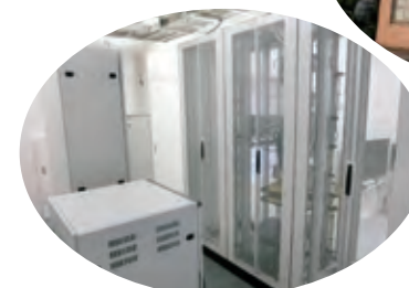
本匠サブセンターのヘッドエンド機器
