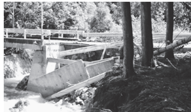
浅海井浦（上浦）の崩落した道路
