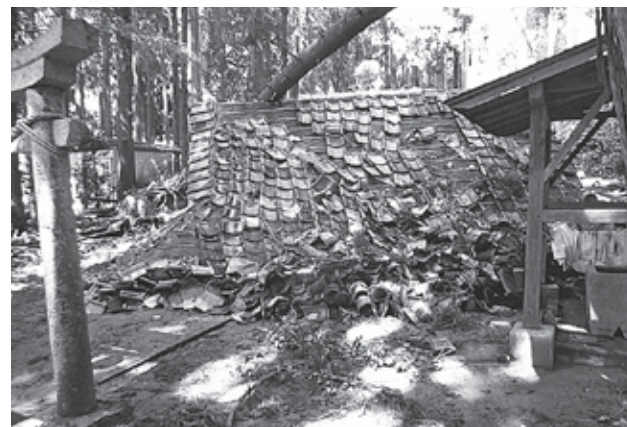
倒壊した大入島石間神社
