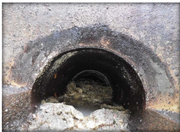
下水道が詰まっている状態
