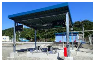
広域浜プランにより大分県漁協が整備した米水津地区の燃油補給施設
