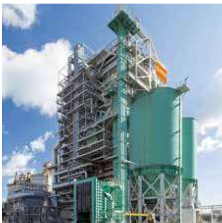
バイオマス発電所
