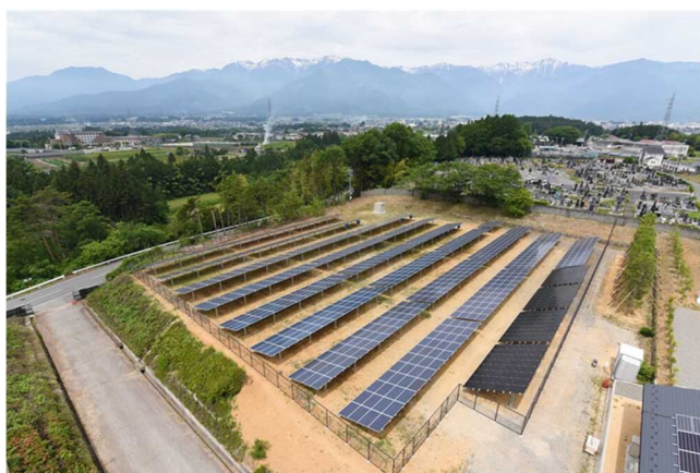
図表 56 リユース品を使用した発電所
